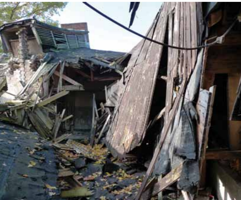
Blick in den Mitteltrakt der ehemaligen Lagerküche. Das Dach ist vollständig eingestürzt. © Andreas Ehresmann
